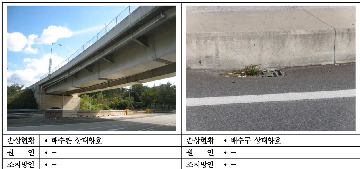
【사진 13.3.20】 배수시설 손상현황
